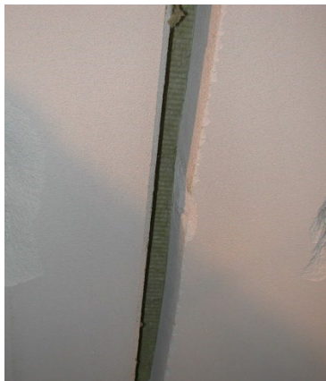
Typisk eksempel på lineær fuge i gulv med åpning under 30mm bredde
